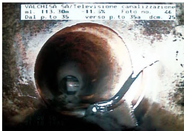
Foto 10: Giunto rotto con guarnizione sporgente da riparare presso pozzetto no. 36 con robot
