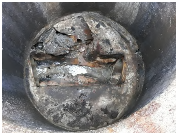
Foto 14: Pozzetto no. 28c, fondo rotto (esempio)
