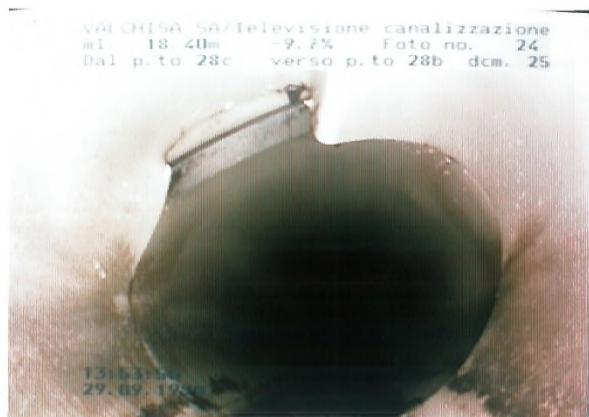
Foto 7: Giunto rotto con guarnizione sporgente da riparare tratta 28b-33 con robot
