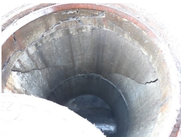
Foto 15: Pozzetto no. 94a, crepe nelle pareti
