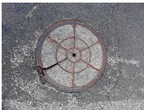
Foto 16: Pozzetto no. 18a, chiusino rotto (esempio)
