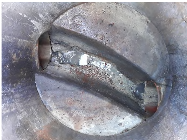
Foto 13: Pozzetto no. 34a, fondo rotto (esempio)
