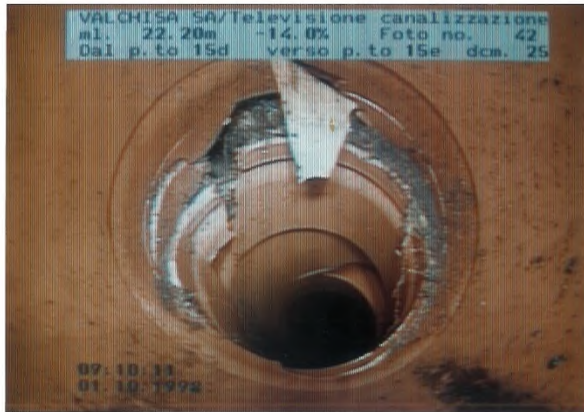
Foto 11: Rottura grave da riparare con scavo tratta 15d-15e
