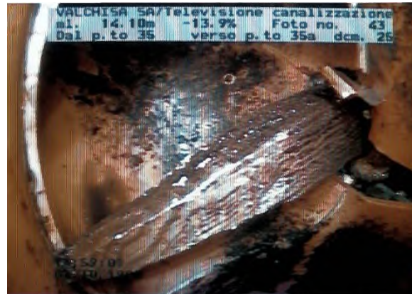
Foto 12: Rottura grave da riparare con il robot tratta 35-35a
