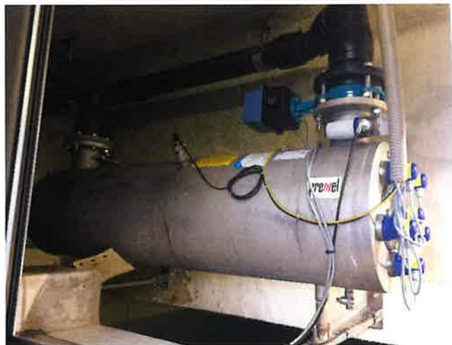
Figura 2 - Impianto UV al SE Orgnana: collettore UV e valvola motorizzata posti sopra la vasca di accumulo principale
