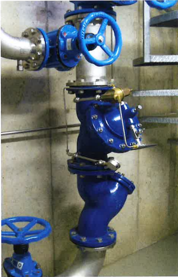
Figura 7 - Filtro a Y e valvola di sostegno pressione esistenti (da smantellare)
