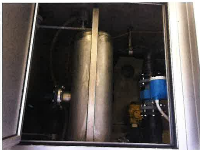
Figura 1 - Impianto UV al SE Orgnana: sgasatore e valvola di rigetto posti sopra la vaschetta di raccolta dell'acqua in entrata
