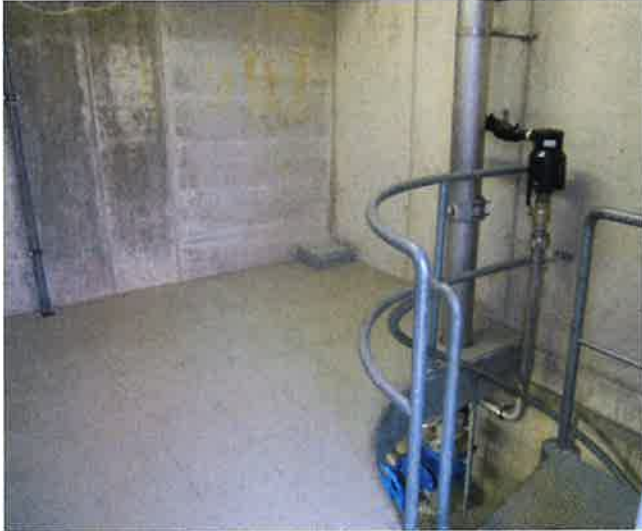
Figura 3 - SE Bruno: camera di manovra piano superiore
