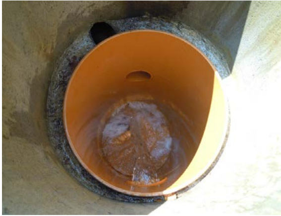
Pozzetto di confluenza del drenaggio (condotte e pozzetto in PVC)
