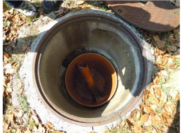
Chiusino pozzetto di confluenza del drenaggio (non a tenuta ermetica)
