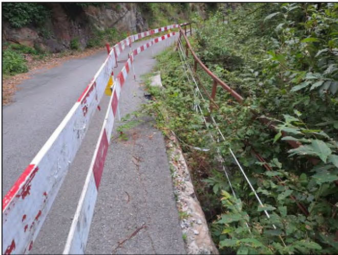
Figura 7: Stato cordolo esistente (19.07.22)
