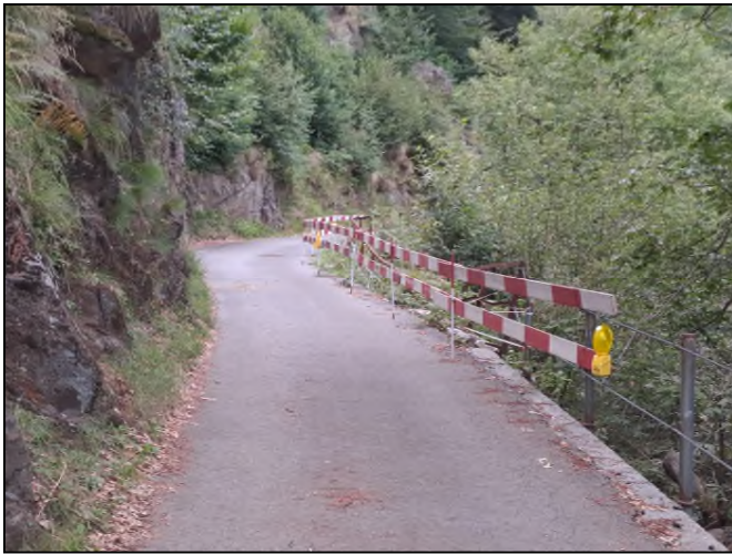
Figura 5: Stato cordolo esistente (19.07.22)
