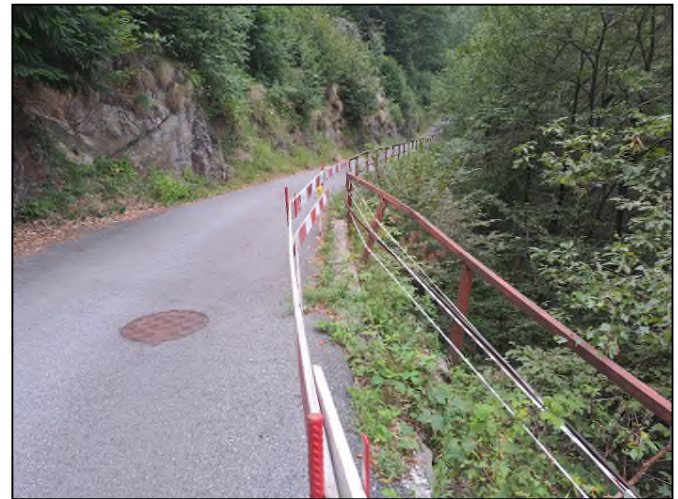
Figura 8: Stato cordolo esistente (19.07.22)
