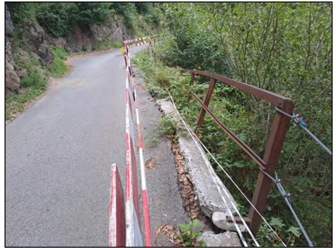
Figura 6: Stato cordolo esistente (19.07.22)
