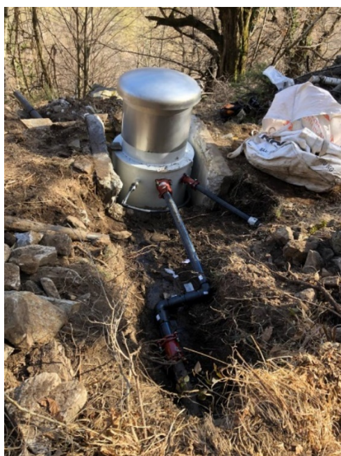
Foto 4: esterno camera di rottura (esempio)
