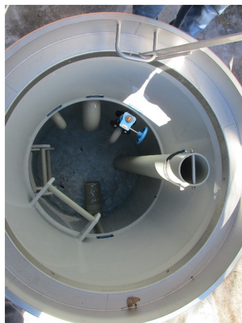
Foto 5: interno camera di rottura (esempio)
