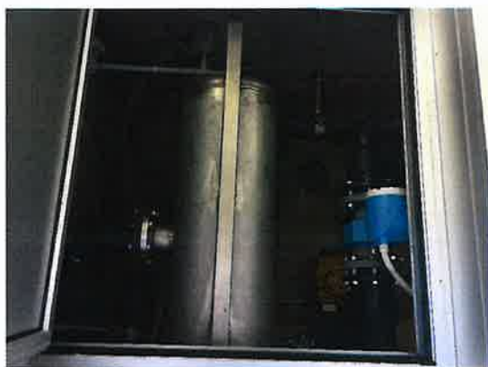
Impianto UV al SE Orgnana: sgasatore e valvola di rigetto posti sopra la vaschetta di raccolta dell'acqua in entrata
