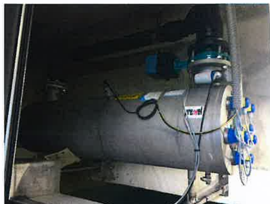
Impianto UV al SE Orgnana: collettore UV e valvola motorizzata posti sopra la vasca di accumulo principale
